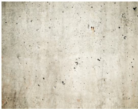
Hormigón con nido de abeja
